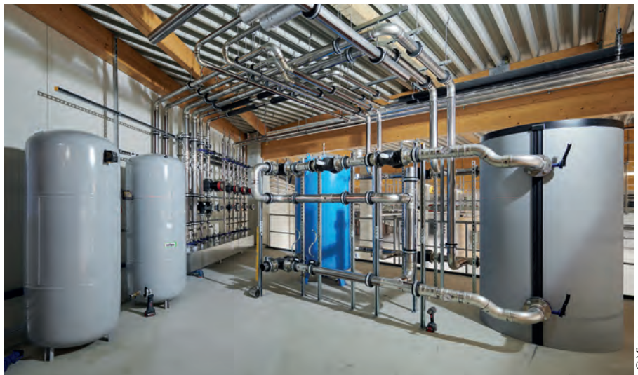
Eine Installation wie aus dem Showroom: die Wärme-/Kältezentrale in dem künftigen medizintechnischen Produktionsbetrieb im Überblick.
